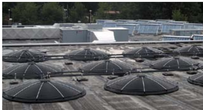
Heatpipes (voor efficiënte warmteverplaatsing) op het dak van zwembad.
